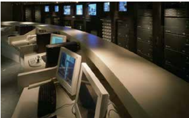
1.23 中控室 - 能源管理及控制系統
