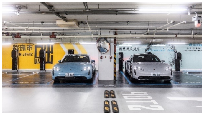
B3F、B4F 電動車充電站
